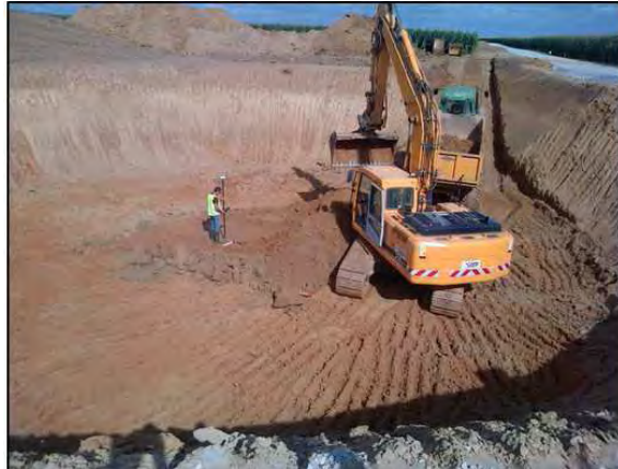
Photographie 4 : Réalisation d'une des fouilles du chantier du parc éolien de Caix
